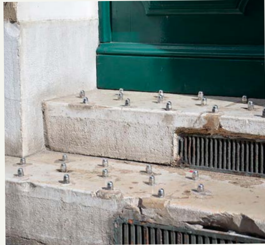
Boulons anti-SDF sur un perron (Marseille, France)
